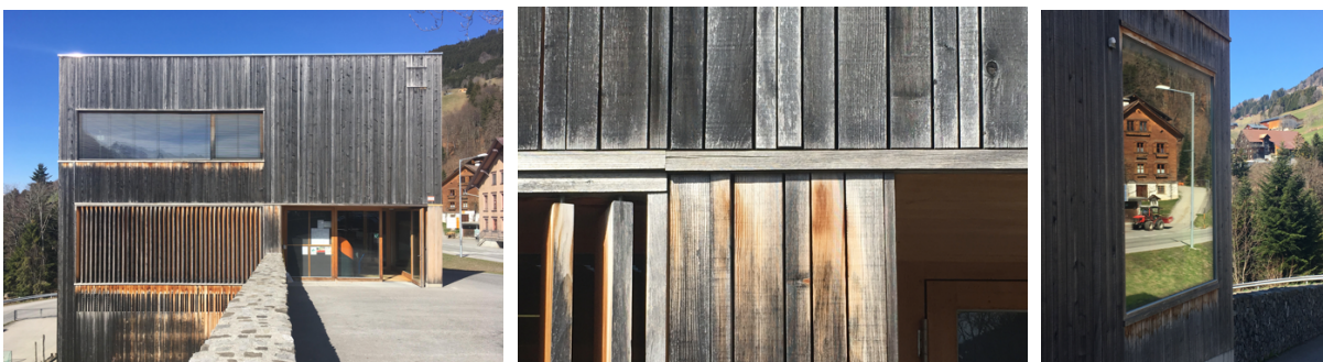
Folgen des Verwitterungsprozesses am Beispiel des Gemeindezentrums St. Gerold, Cukrowicz Nachbaur Architekten, 2008, Foto: Maren Kohaus, 2019
