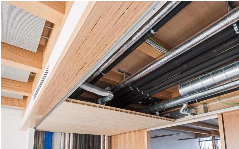
Abb. 25 - klare Systemtrennung zwischen Holzbau und Rohrleitungsführung in der dafür ausgewiesenen Deckenzone (Neubau euregon AG, lattkearchitekten)
