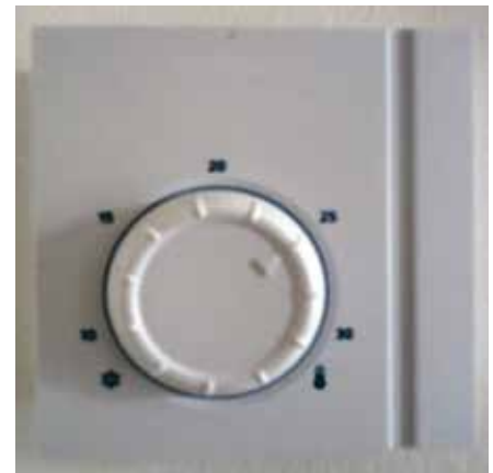
Abb. 123: Thermostatregler für die Fußbodenheizung
