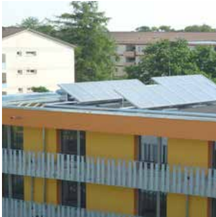
Abb. 159: Solarthermische Anlage in München
