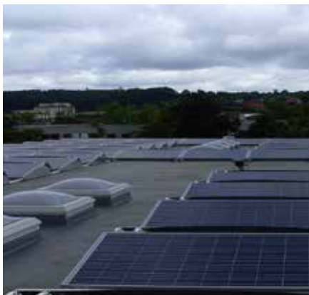
Abb. 161: Photovoltaikanlage in Ansbach
