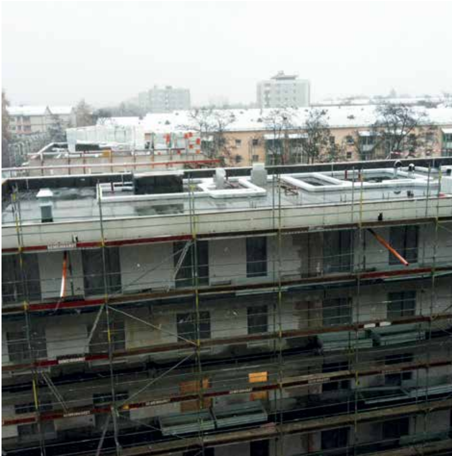
Abb. 125: Lüftungsleitungen auf dem Dach vor der Überdämmung
