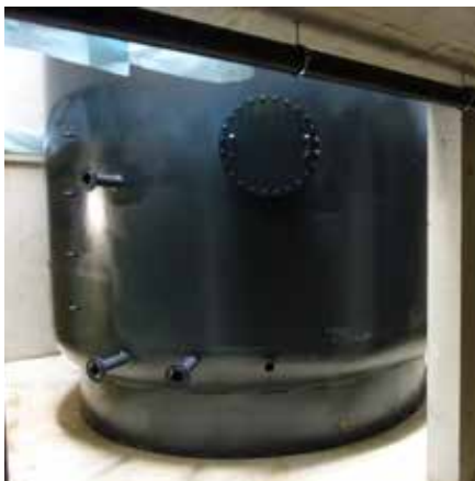
Abb. 160: Warmwasserspeicher in Ingolstadt Bauteil 1
