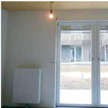
Abb. 79: Wohnzimmer mit Heizkörper
