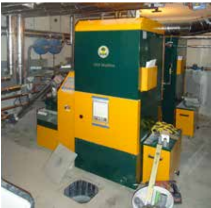
Abb. 40: Pelletkessel im Kellergeschoß
