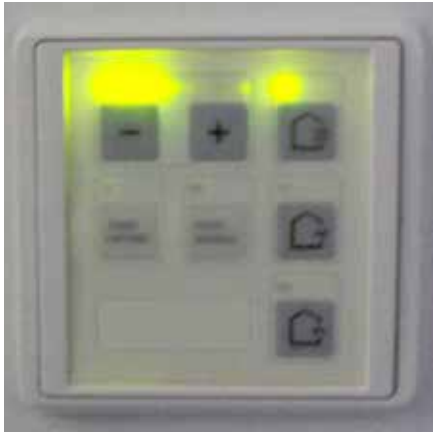
Abb. 108: Bedienelement der Lüftungsanlage im Flur
