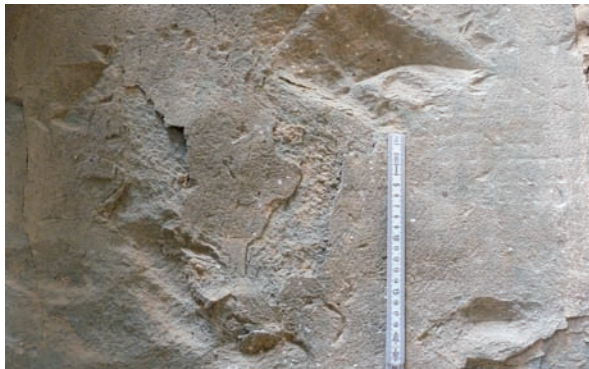
Abb. 9: Musterfläche 2, gereinigt / Fig. 9: Example 2, cleaned
