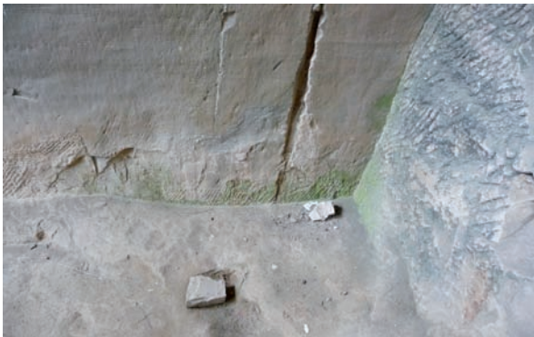
Abb. 17: Südostecke, Grünalgenbewuchs / Fig. 17: Southeast corner, with green algae
