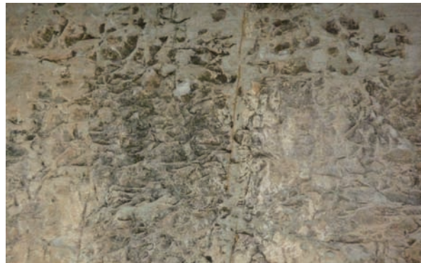
Abb. 18: Westlicher Teil der Südwand (oben mit schwarzem Algenbewuchs) / Fig. 18: South wall, western part with black algae in the upper part of the wall
